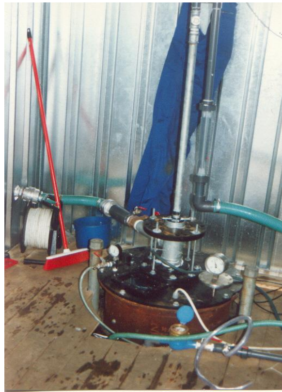
Abb. 3: Brunnenkopf mit Prozessgaszuführungs- und Abgasabsaugvorrichtung
